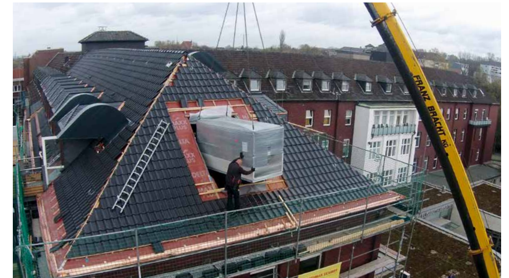
Unten: Im St. Elisabeth-Hospital hat die KKB-Technik für die Intensivstation und die Endoskopie ein modernes energieeffizientes Lüftungsgerät eingebaut.
